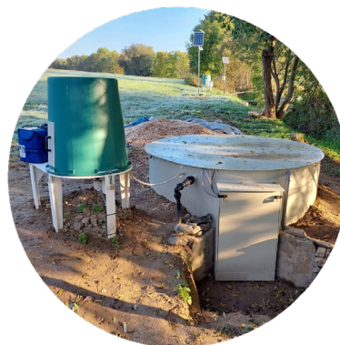
Figura 1: Un esempio reale di bioreattore semi-operativo installato.
